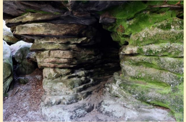
L'Éléphant nord, dalle supérieure, fractures en cisaillement horizontal
